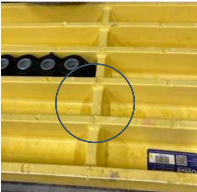
Riss entlang einer Querverstrebung
